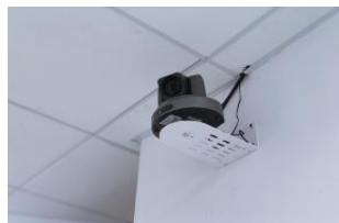
中心信息化监控设施建设
